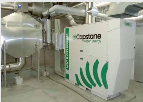
Neue Microgasturbine in der Kläranlage Horgen-Oberrieden
