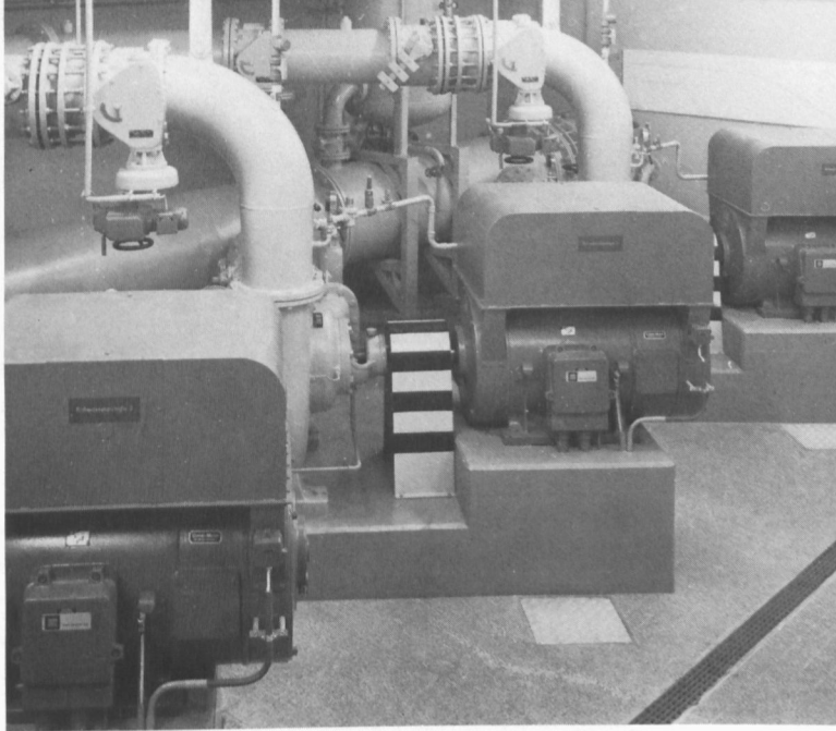
Die drei Rohwasserpumpen im unterirdischen Rohwasserpumpwerk Au
