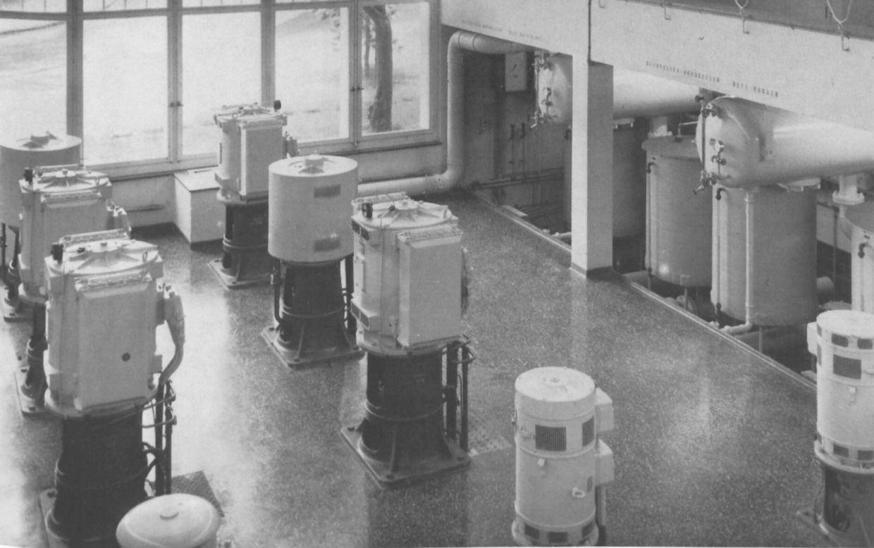
Pumpenraum des heutigen Seewasserwerkes Hirsacher. Im Rohrkeller (rechts) ist die seit Ende 1978 in Betrieb stehende Flockungsanlage sichtbar.
