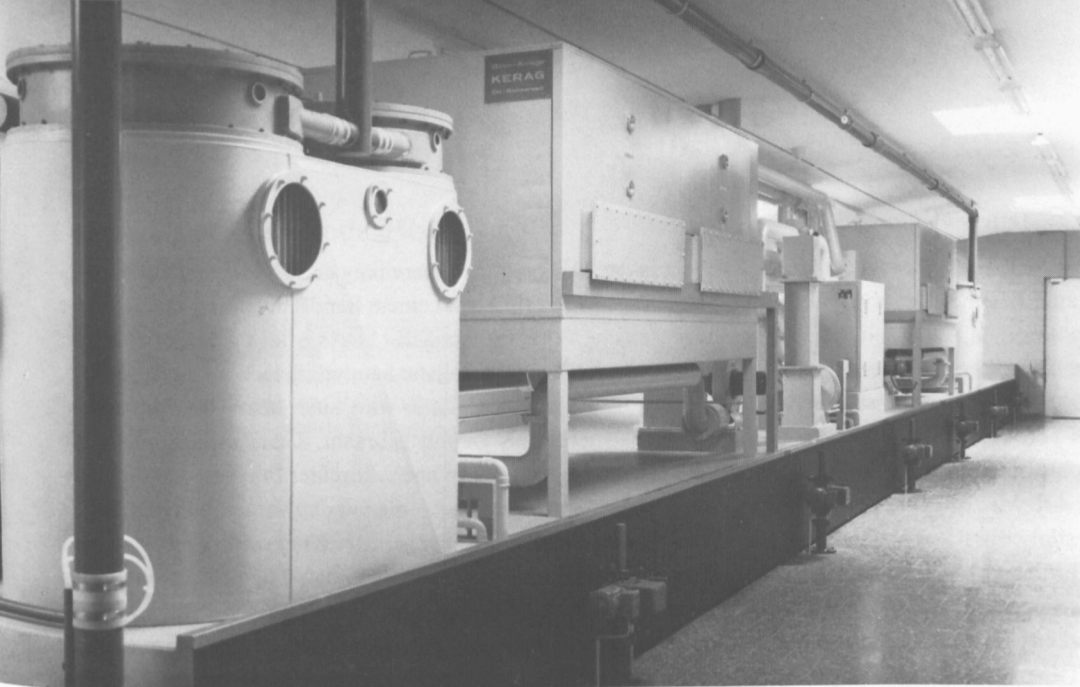
Ozon-Anlage im Aufbereitungswerk Appital. Die grossen rechteckigen Kasten sind die Trocknerelemente zur Lufttrocknung; links und rechts anschliessend die Ozonatoren, welche mittels Hochspannung von 7000 Volt das Ozon erzeugen.
