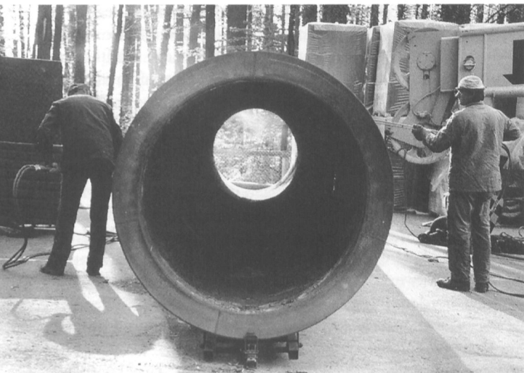
April 1991: Der alte, seit 1976 im Dienst stehende Kamin wird demontiert. Sein Innendurchmesser betrug 1,30 m.
